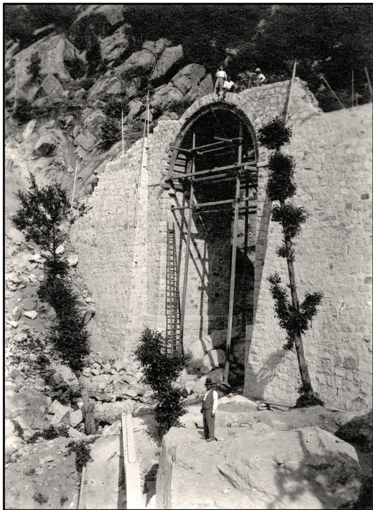
Costruzione del Ponte dei Righi lungo la strada provinciale tra Marciana e Patresi, in una fotografia del 1928. Ai lavori parteciparono diversi lavoratori stagionali provenienti dall'Appennino emiliano, i cosiddetti lombardi .
